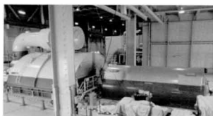
蒸気タービン発電機
