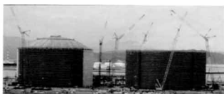
国際石油開発帝石（株）LNGタンク
